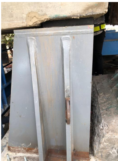
写真－15 コンクリート桁用の鋼製台座
