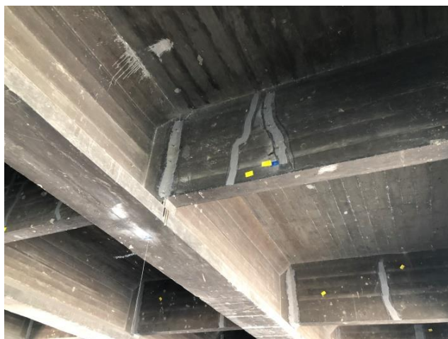
写真－14 PC 桁・横桁部のひび割れ箇所(補修済み)
