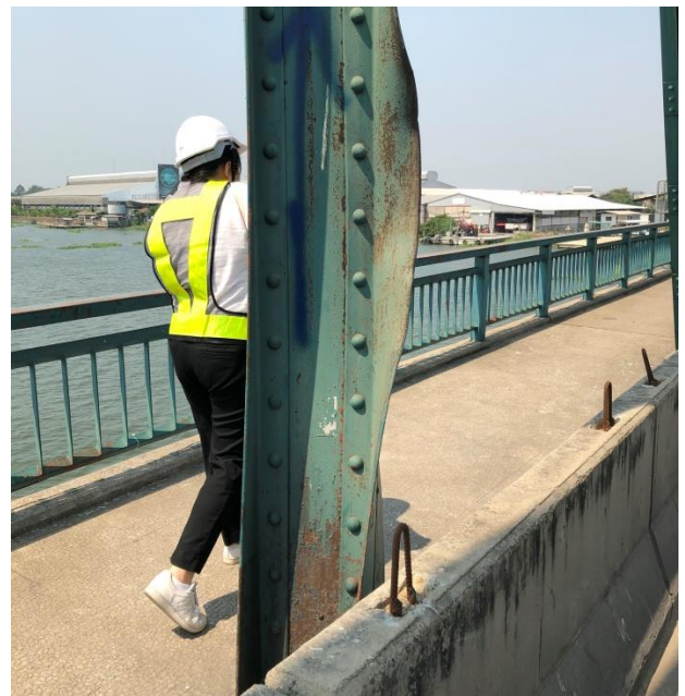
写真－12 衝突による部材の変形
