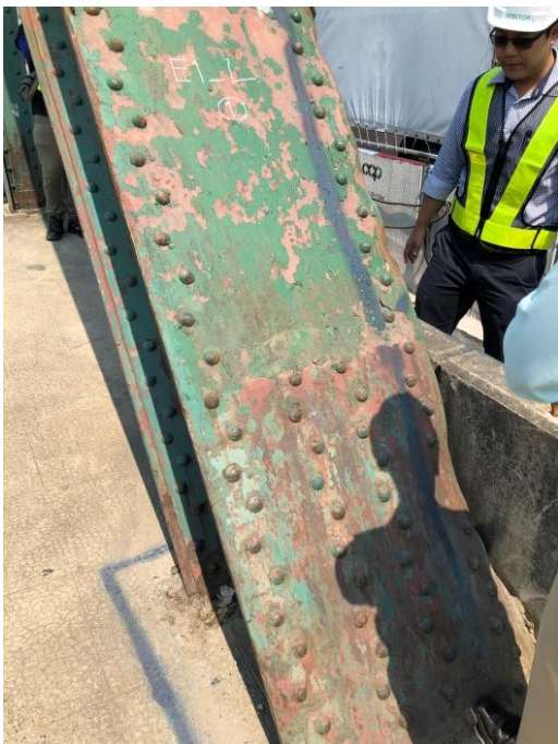
写真-5 斜材の塗膜劣化
