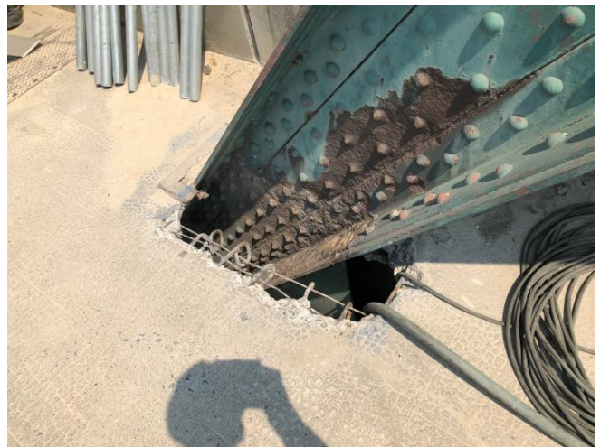
写真－10 トラス部の斜材の腐食状況
